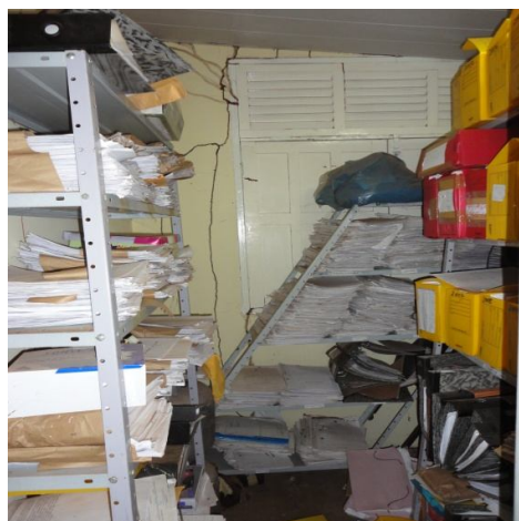
Foto 9- Sala de Arquivo com teto arreado e cupim
