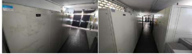
Vista dos quadros em 380V da Subestação.
