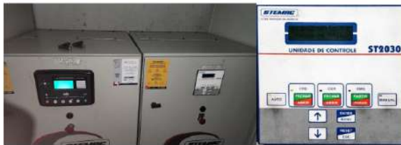
Vista do quadro QTA existente.
