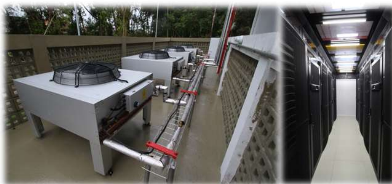
Figura 23 – Componentes do sistema de refrigeração de precisão da sala segura
