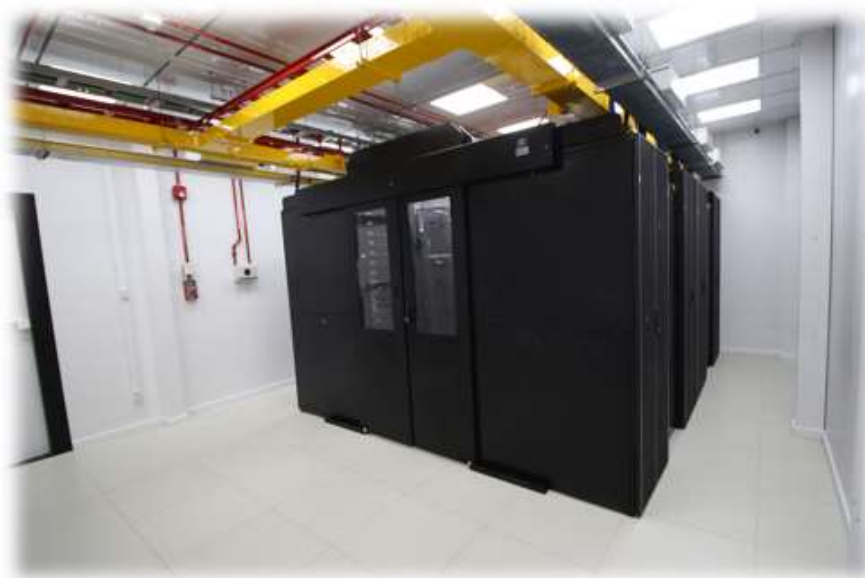
Figura 30 – Foto do interior da sala segura
