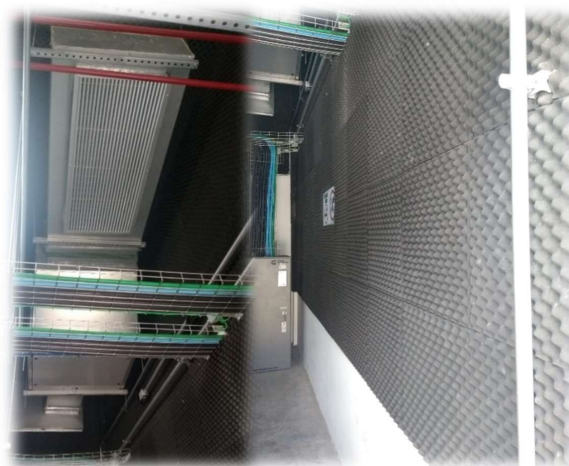
Figura 15 – Detalhe de exaustor no teto e revestimento antirruído em sala de gerador
