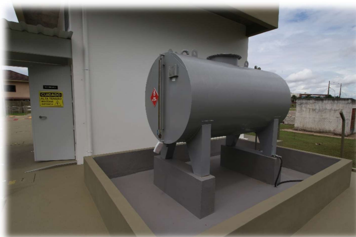
Figura 20 – Tanque de óleo diesel com capacidade de 3.000 litros
