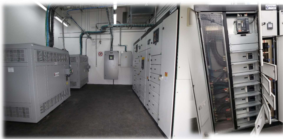
Figura 10 – Transformadores e QGBT
