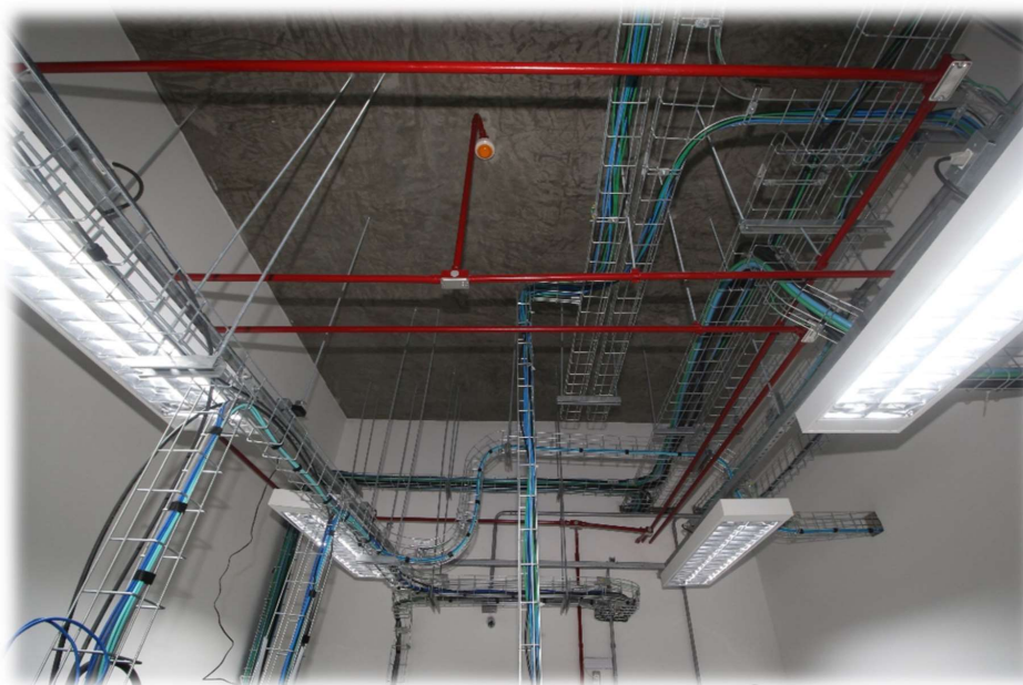
Figura 18.b – Luminárias e leitos aramados no teto
