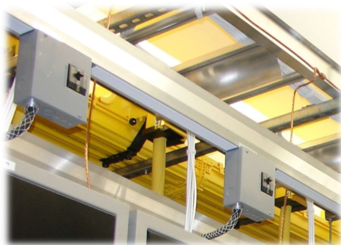
Figura 13 – Detalhes do barramento de alimentação da sala segura
