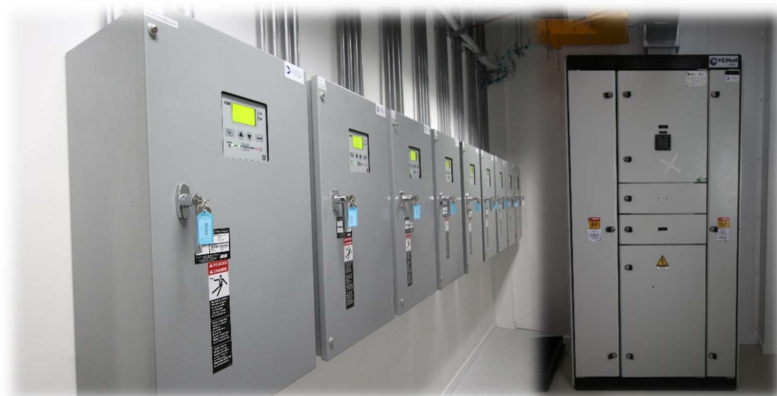
Figura 12 – Detalhes de alguns quadros elétricos
