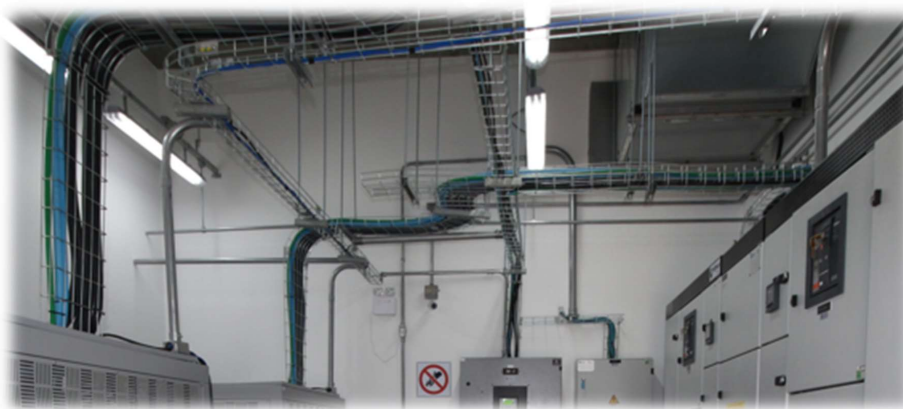
Figura 11 – Detalhes da infraestrutura de encaminhamento e proteção de cabos elétricos
