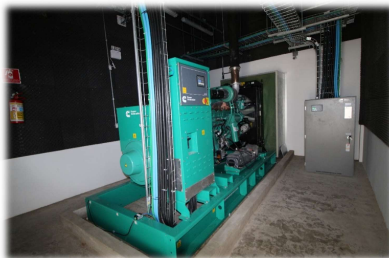
Figura 19 – Gerador a diesel com tanque de combustível na base
