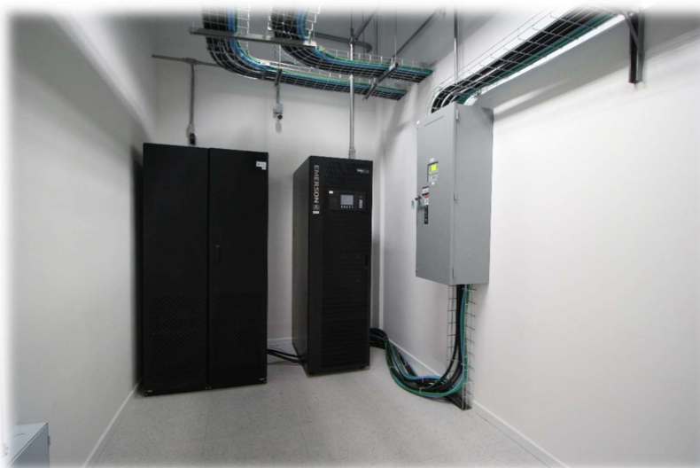
Figura 16 – Componentes UPS (Módulo de controle e banco de baterias)
