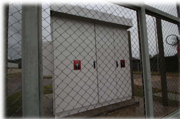
Figura 08 – Cubículo de medição na entrada de acesso
